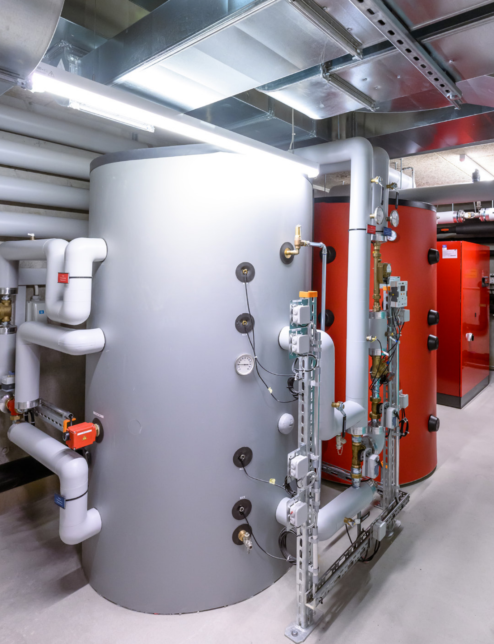
Speicher im Wärmeverbund Bodmen in Reinach, der dieses Jahr in Betrieb ging. Die Wärme stammt aus acht Erdsonden, die von Wärmepumpen auf Heizniveau gebracht werden (siehe Anlagenporträt auf S. 12).
